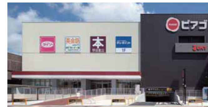
ピアゴ守山店改修後 6階建て既存店舗を4層減築し、一部耐震改修を施した
